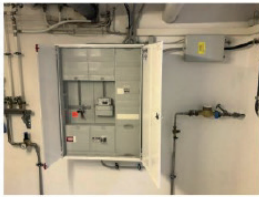
Aus der Entfernung - Zählerschrank
